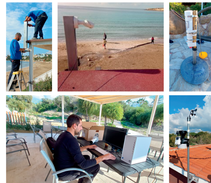
Σύστημα παρακολούθησης παράκτιων διεργασιών (εγκατάσταση κάμερας, μετεωρολογικού σταθμού και κυματογράφου)
